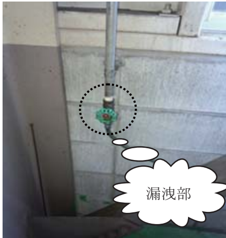
漏洩部の一例
