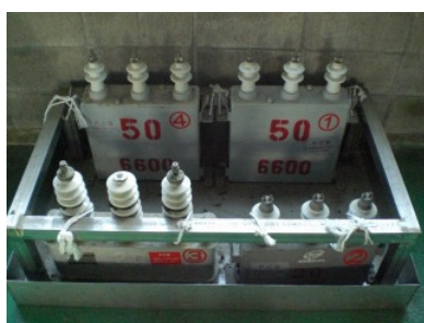
PCB コンデンサー（4基）
