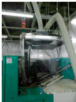
細呂木サイト：油煙除去装置
