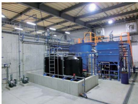
能登サイト：新排水処理施設
