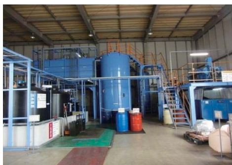
加賀サイト：排水処理施設
